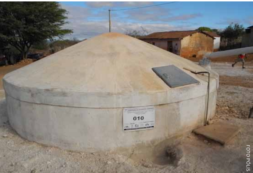
Figura 3 Cisterna construída no âmbito do P1MC
