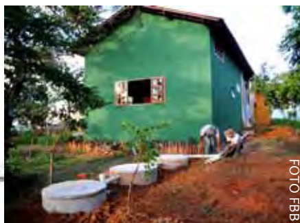
Figura 24B Fossa séptica biodigestora instalada próximo a residência Fonte: Banco de Tecnologia Social /FBB
